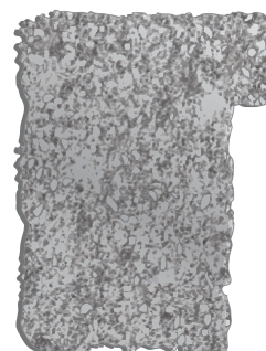
Requiere sustitución Deve essere sostituita
